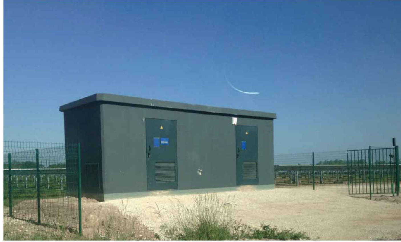
Vue du poste de livraison - Béton peint vert RAL 6011
